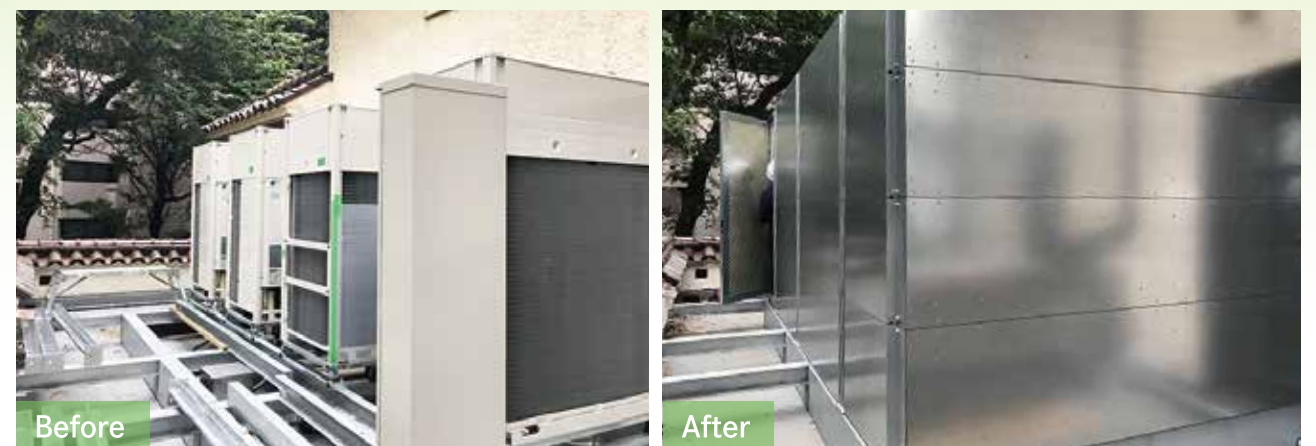
都内某所 室外機用遮音壁 気流解析と騒音解析を行い、厳しい設置条件をクリアしました。
