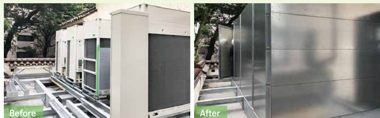
都内某所 室外機用遮音壁 気流解析と騒音解析を行い、厳しい設置条件をクリアしました。
