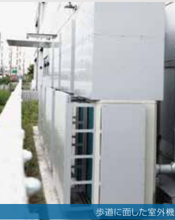
歩道に面した室外機
