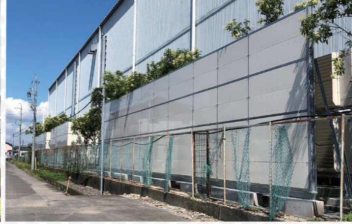
合計80mの設備機器用遮音壁を設置。塗装を施し外観にも配慮
