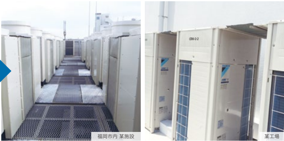
福岡市内 某施設
