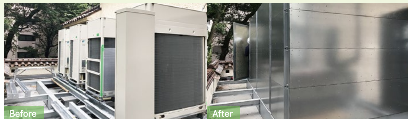
都内某所 室外機用遮音壁 気流解析と騒音解析を行い、厳しい設置条件をクリアしました。
