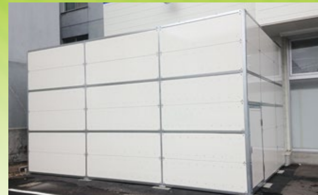
札幌某所 室外機用遮音壁
