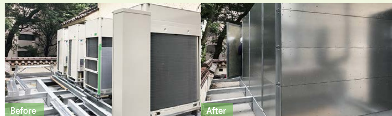
都内某所 室外機用遮音壁 気流解析と騒音解析を行い、厳しい設置条件をクリアしました。
