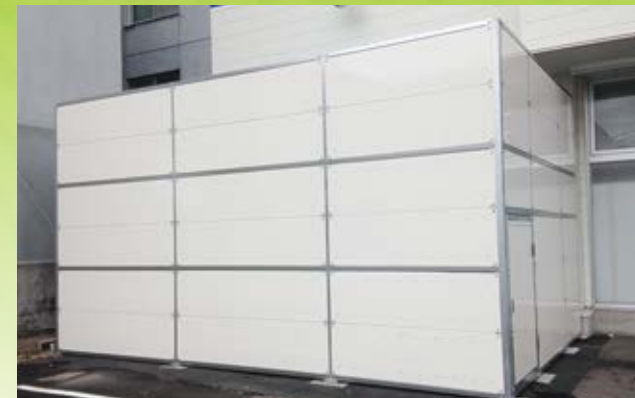
札幌某所 室外機用遮音壁
