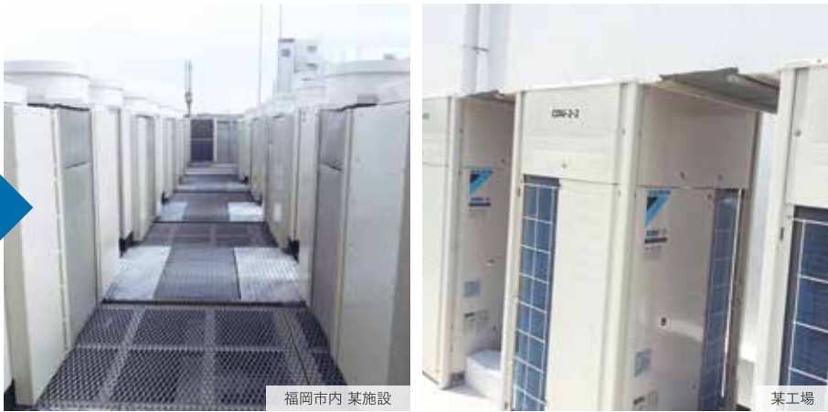
福岡市内 某施設
